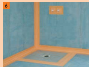
6 Po položení, slepení a sešroubování podlahových prvků Powerpanel TE jsou plochy natřeny základním nátěrem FERMACELL a v oblastech napojení umístěn těsnicí systém
