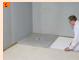
5 Wariant 1b: na wysokości góry zakładki elementu odpływowego FERMACELL ułożyć 10 mm styropianu (EPS DE0 150)
