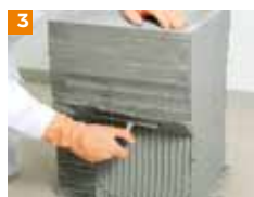
Klej rozprowadzamy za pomocą szpachli o odpowiednim uzębieniu (6 do 8 mm) po dwóch stronach stosu płyt
