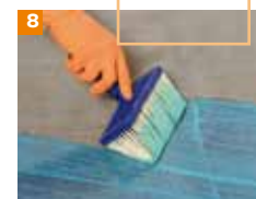
Kiedy powierzchnia nadaje się do chodzenia, należy wykonać dwukrotnie całopowierzchniowe gruntowanie Powerpanel SE.
