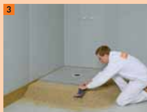
3 Varianta 1b: aby byla dosažena výška stupňovité drážky sprchového prvku, je po ploše umístěna izolace (EPS DEO 150) ve vrstvě 10 mm
