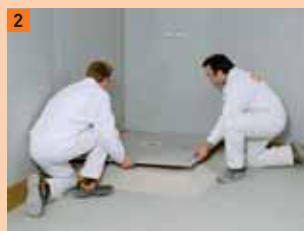
2 Varianta 1a: kolem sprchového prvku je ve výši přesahujícího stupně nasypána cca 200 mm široká hráz jako základ pro stažení zbývajících ploch
