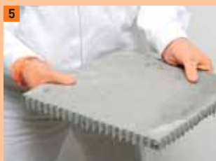
5 S 6 mm zubovou stěrkou je lepidlo nanášeno na dvou stranách stohu podlahových prvků
